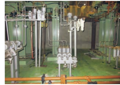
中国・湖南工場に設置した蒸気配管へのドレンポケット
