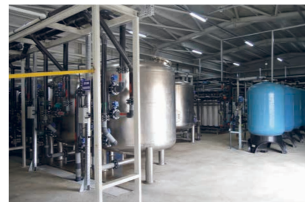
排水リサイクル設備(トルコ工場)
